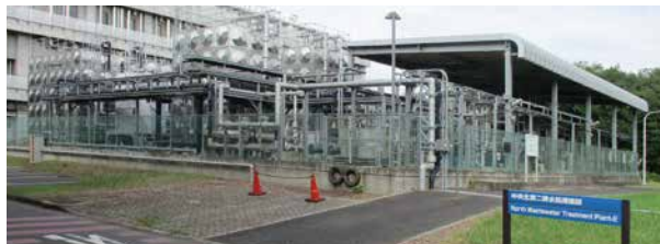
つくばセンター内の廃水処理施設
