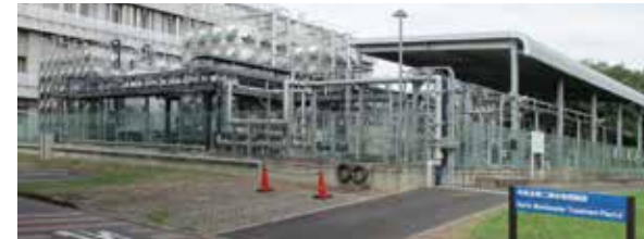
つくばセンター内の廃水処理施設
