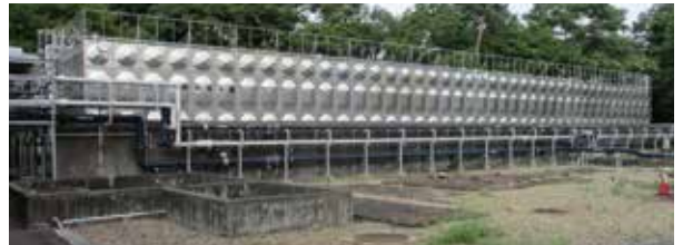
つくばセンター内の再利用水槽
