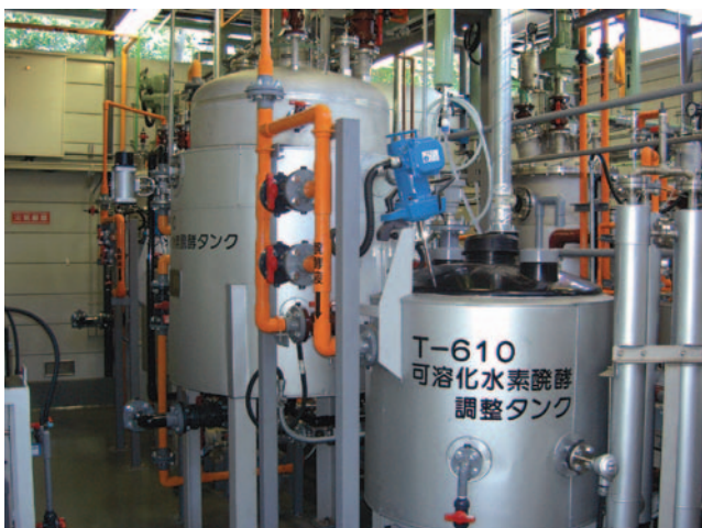
写真 2 可溶化・水素醱酵槽（右側）
