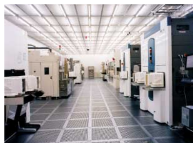
スーパークリーンルーム（クラス3）
