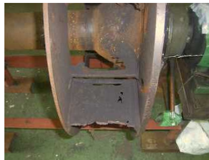
侵食された送風機
