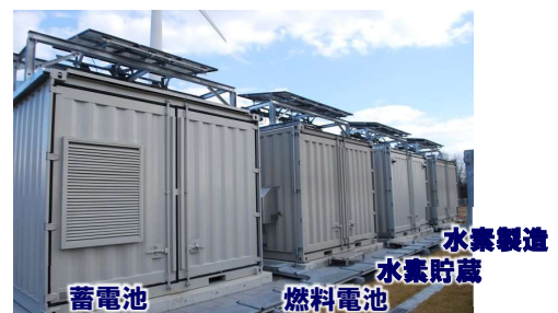
構築した水素エネルギーシステム実証設備(12フィートコンテナ4つから構成され、BEMSから運転制御される。)
