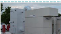
アンモニア直接燃焼マイクロガスタービン発電装置
