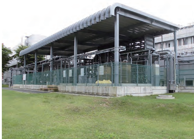
つくばセンター内の廃水処理施設
