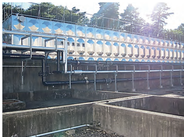
つくばセンター内の再利用水槽
