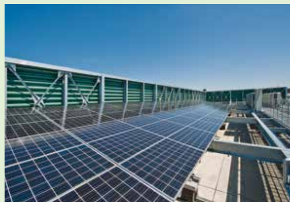
屋上に設置した太陽光発電パネル
