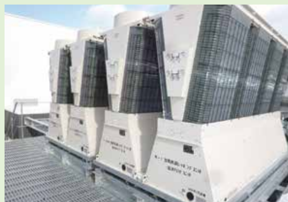
高効率モジュールチラーの採用
