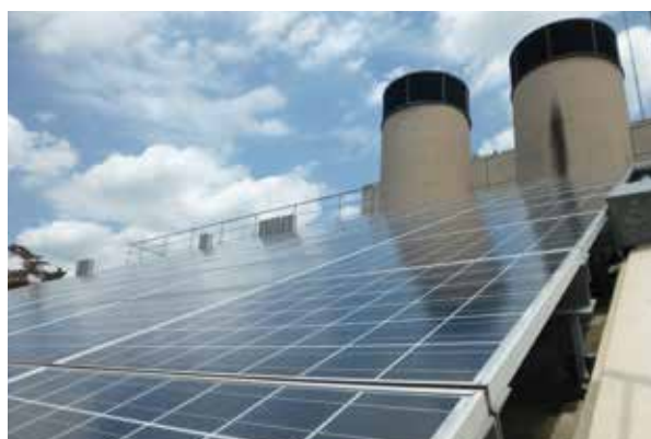
太陽光発電システム
