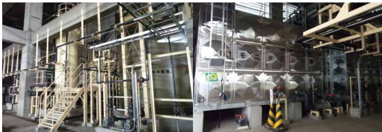
つくばセンター内の廃水処理施設
