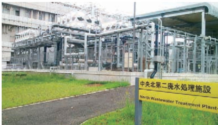
つくばセンター内の废水处理施設
