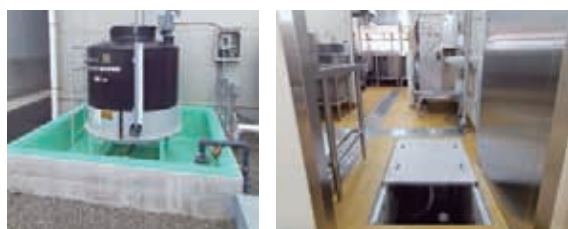
排ガス洗浄設備の廃液貯留槽に設置した防液堤 グリーストラップに接続した油分回収装置
