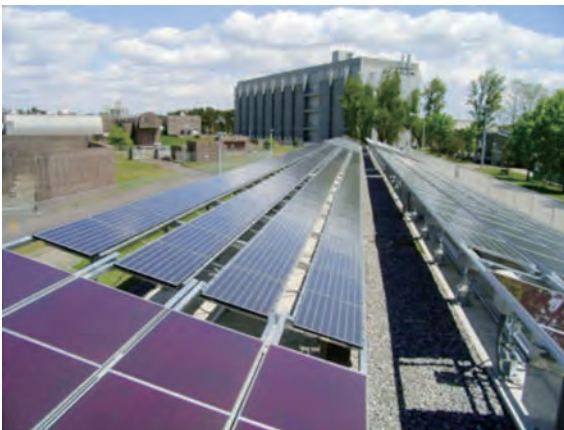
つくばセンターの太陽光発電パネル
