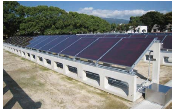
九州センター 太陽電池屋外評価設備
