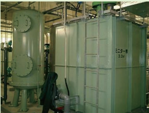
活性炭吸着塔とモニター槽
