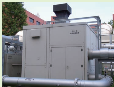
熱源供給施設のリニューアルにより つくば中央第5事業所に設置された冷温水発生機のボイラー部分
