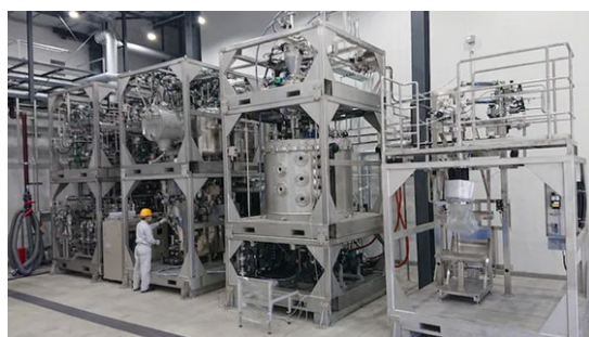
高砂ケミカル掛川工場に構築された実証プラント
