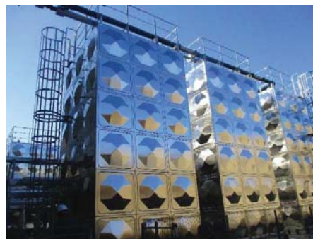
研究廃水処理施設 (改修後)
