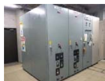
受変電設備(改修前)
