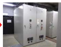
受変電設備(改修後)
