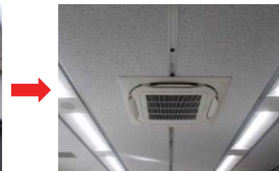
空調設備（更新後）
