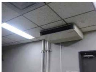
空調設備（更新前）
