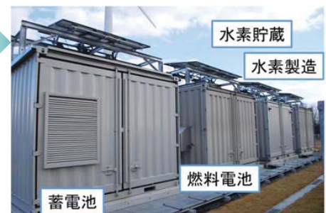
ZEB用水素システム
