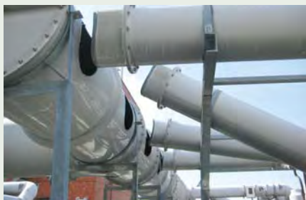
屋上設置のスクラバ配管の損傷
