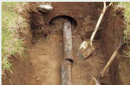
研究排水管が外れた箇所
