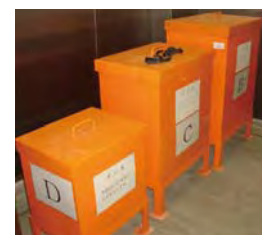
PCB保管庫内の様子
