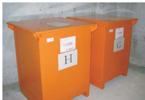
PCB保管庫内の様子
