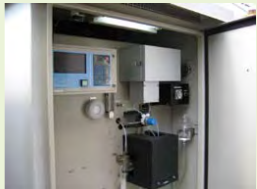
排ガスモニタリング装置（塩化水素）
