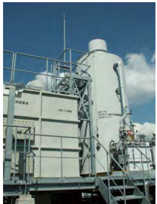
排ガス処理装置
