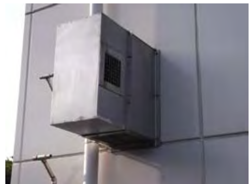
排気口に取付けた消音フード (つくばセンター)
