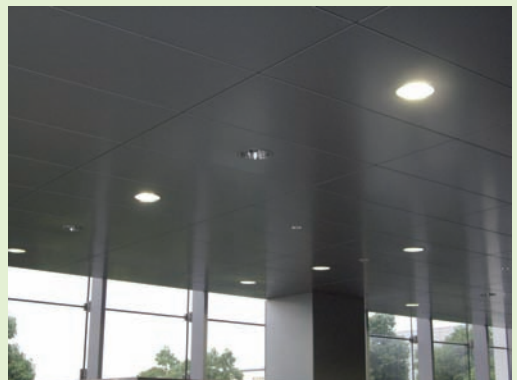
照明の間引き（臨海副都心センター）
