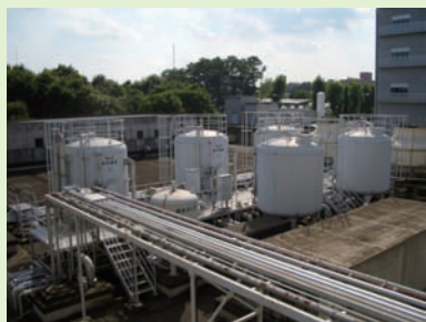
研究廃水ろ過装置
