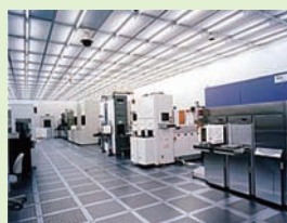
SCR クリーンルーム内
