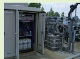
処理施設 フッ素濃度モニター
