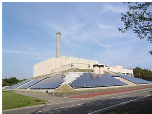
のり面利用型太陽光発電システム エネルギーセンターの、のり面を利用した太陽光発電システムです。遊休スペースを有効に活用し、今後わが国で導入が期待されている河川堤防や休耕地への太陽光発電システムの利用に1つの方法を提案しています（232kW）。
