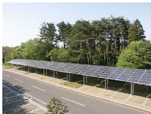
パーキング融合型太陽光発電システム 駐車場に停車する車の日よけとなる屋根を兼ねた、遊休スペースを有効に活用した一石二鳥のパーキング融合型太陽光発電システムです（212kW）。
