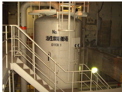
処理プロセス中の活性炭吸着塔
