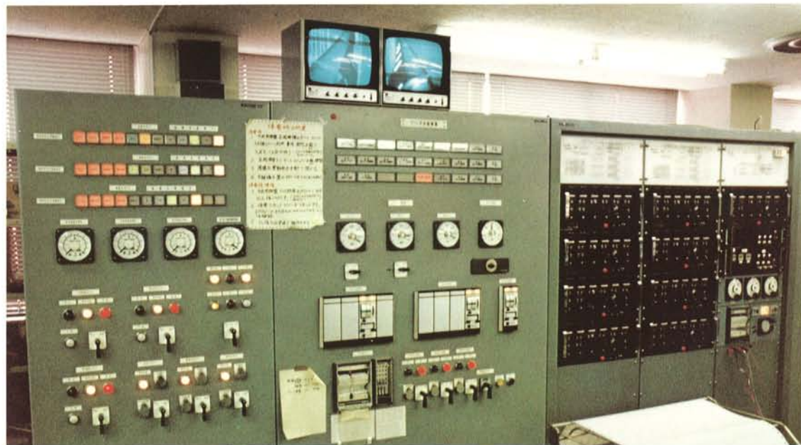
▲潮汐発生装置制御室
