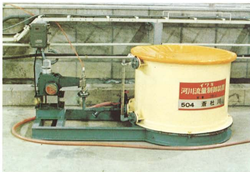
▲定量注入装置
