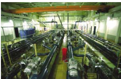
● 写真：石油流量校正設備の計測室
