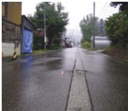
写真1 国道352号線(旧道)の小平尾地内にみられる消雪パイプの座屈変形 数cm程度の水平短縮が生じたものと思われる
