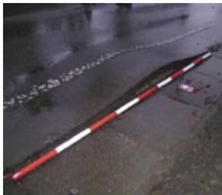
写真2 国道352号線(旧道)の小平尾地内にみられる舗装路面の圧縮変形
