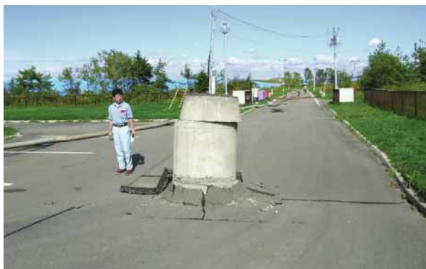
豊頃町大津の下水管マンホールの抜け上がり 下水管理め戻しに使用した砂の液状化により、マンホールが抜け上がったと思われる。背後には、法面が崩壊したため青いシートで覆われた堤防が見える。
