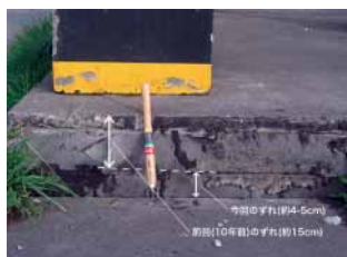
釧路西港第3埠頭のベルトコンベア脚部の抜け上がり
